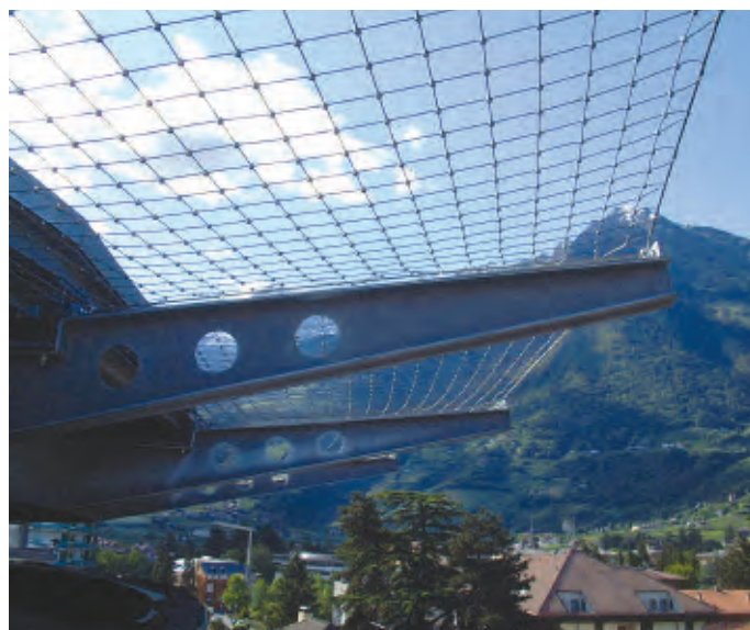
Dralo jako zewnętrzne zabezpieczenie lądowiska dla helikopterów – szpital w Meran
